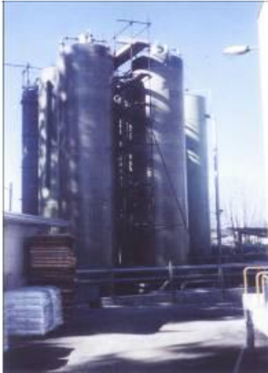
Рис. 5. Сооружения по обработке илового осадка вертикального типа
